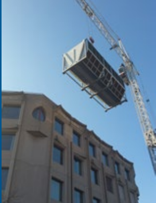
▲ Une grue lève les refroidisseurs adiabatiques JAEGGI, d'un poids de 4 600 kg, sur le toit du bâtiment administratif de DuPont de Nemours.
