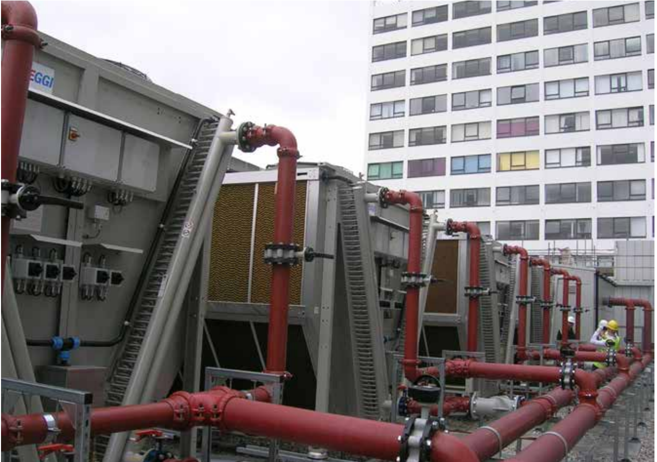
Refroidisseurs ADC pour climatisation de bâtiments à Londres Photo : JAEGGI Hybridtechnologie AG
